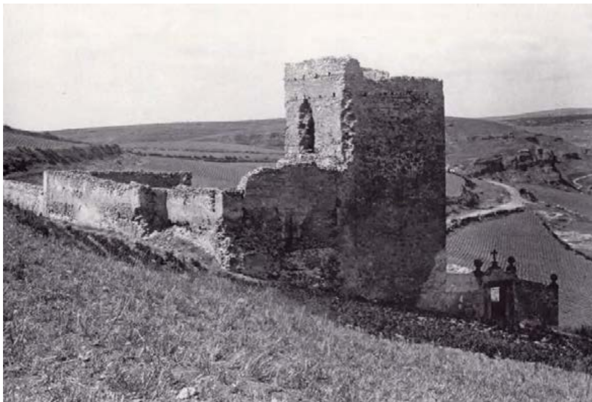
1. Ruina de la iglesia y entrada al antiguo cementerio a finales del s. XIX, principios del XX (Col. Augusto Conde. Enciclopedia del Románico. Vol. III. Pág. 1648)
